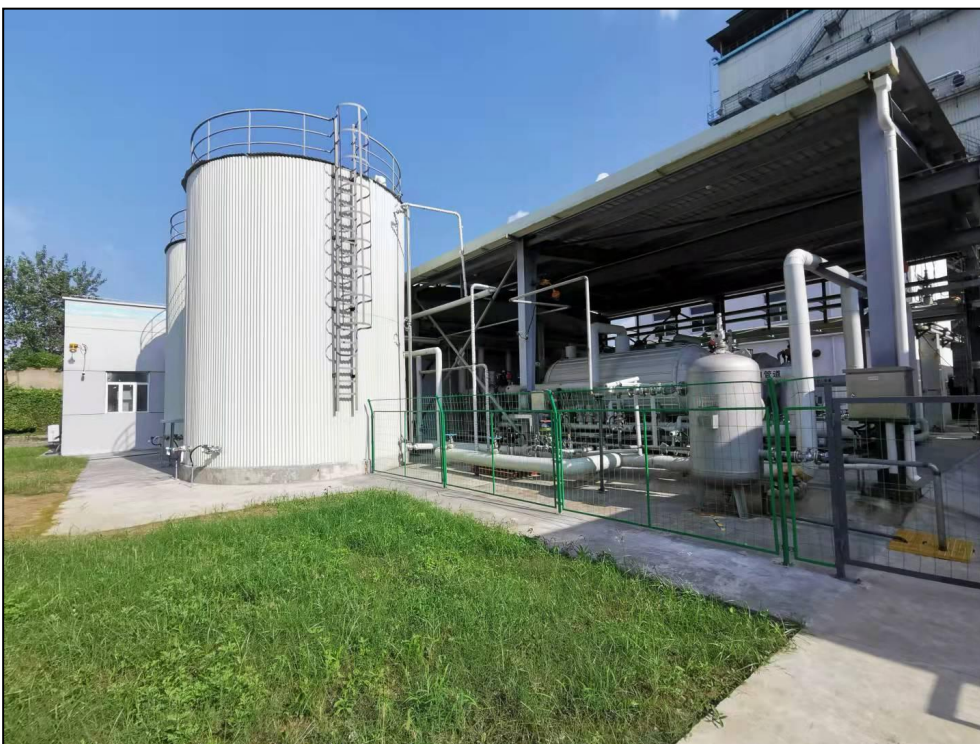
图 2-5 尿素溶液储罐
