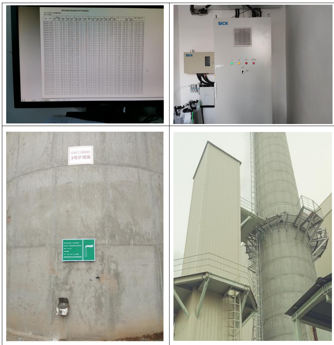
图 4.2-1 项目在线监测设施
