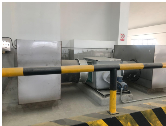
垃圾贮坑密封及一次风机口
